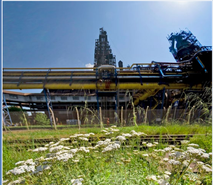
Die 1.000 Meter lange Rohrleitung versorgt das Stahlwerk mit Stickstoff von Messer.
